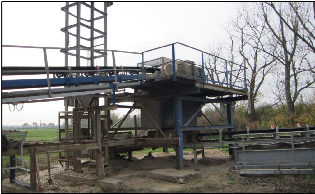
Abbildung 11: Übergabestelle an der Hauptförderstrecke
