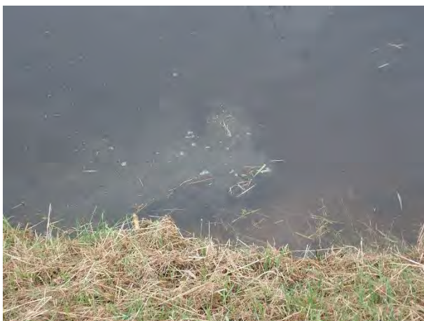
Abbildung 3-62: Moaske (Mitte) – aufgewirbelter Faulschlamm
