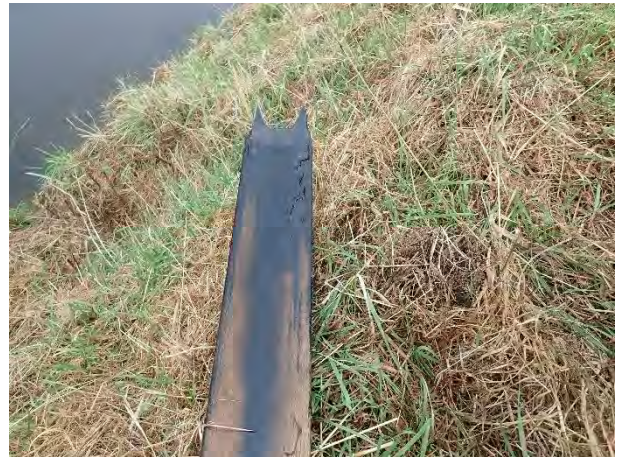
Abbildung 3-61: Moaske (Mitte) – Faulschlammablagerung auf der Sohle
