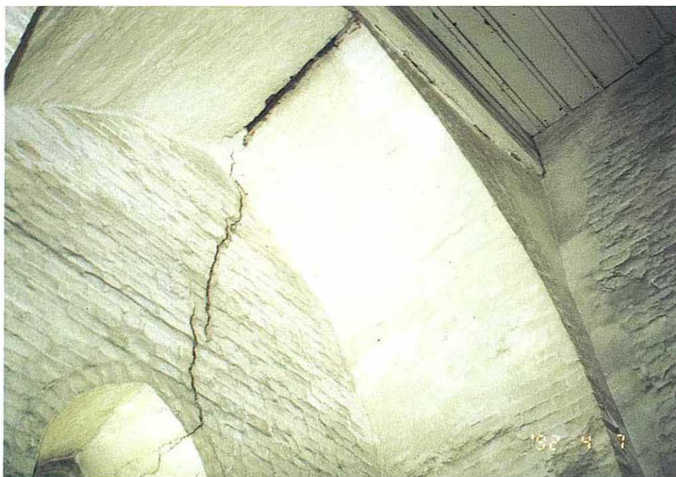
Abb. 5 Turmsüdwand (innen), Rupturverlauf. Kluft im Spitzbogen 7 cm geöffnet. Foto: R. Meier
