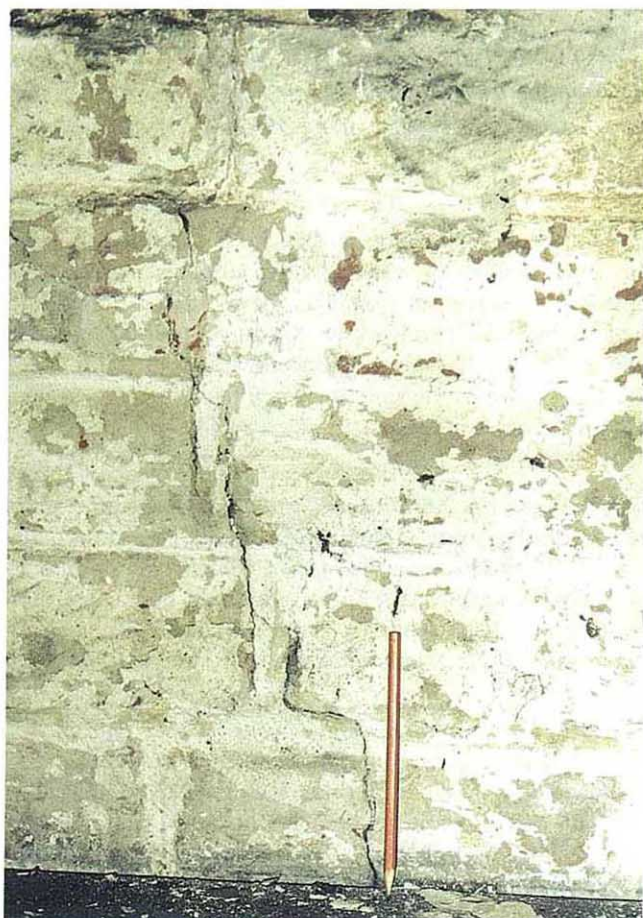
Abb. 6 Turmsüdwand (innen), Rupturverlauf unterhalb des in Abb. 5 noch erkennbaren Fensters. Foto: R. Meier
