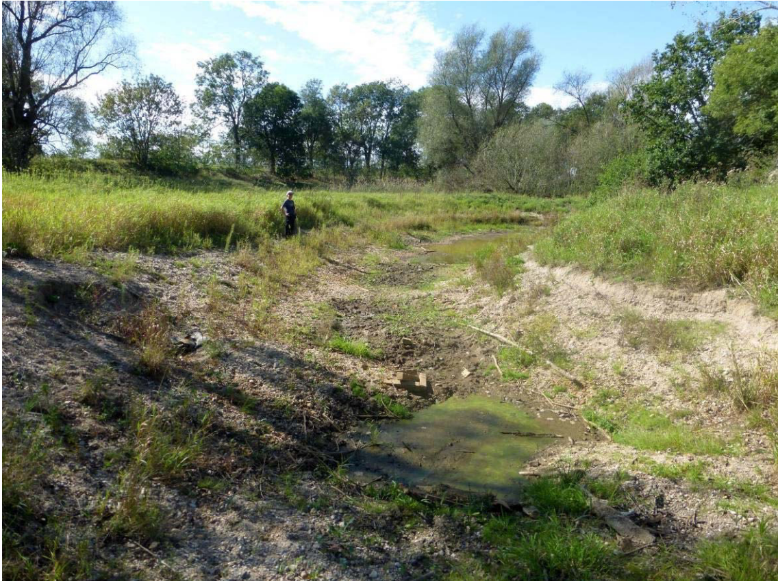
Foto 33: Tümpel in Seeschleuse Mühlberg – bis auf eine Pfütze ausgetrocknet.
