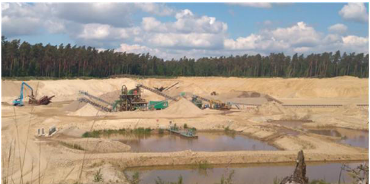
Abbildung 3: Aufbereitungsanlage zur Aufbereitung des Rohstoffes
