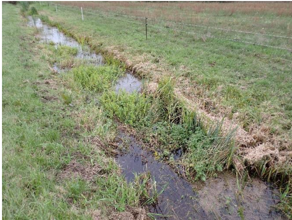
Abbildung 119: Jurkewskigraben (Herbst) 2024, bordvoll eingestaut
