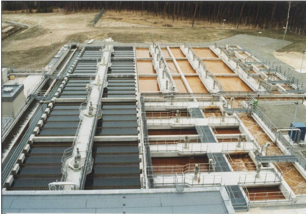
Bild 52: Absetzbecken der GWBA Kraftwerk Jänschwalde, (Foto: LE-B).
