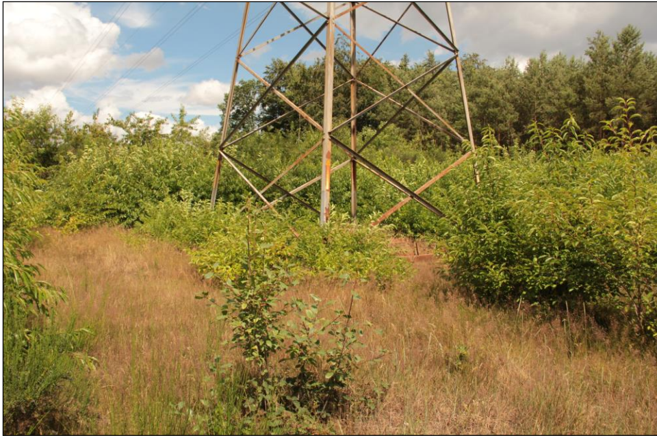
Abbildung 13: Abbildung 14: Bereich um Mast 20
